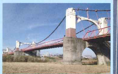
吊橋（5径間連続吊橋）/ 玉手橋 （大阪府藤井寺市～柏原市）/ 平成5年 竣工 補剛桁は平行弦ハウトラス形式
